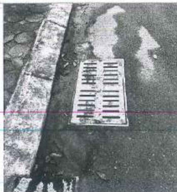
Hình 9. Hồ thu nước mưa của cơ sở
