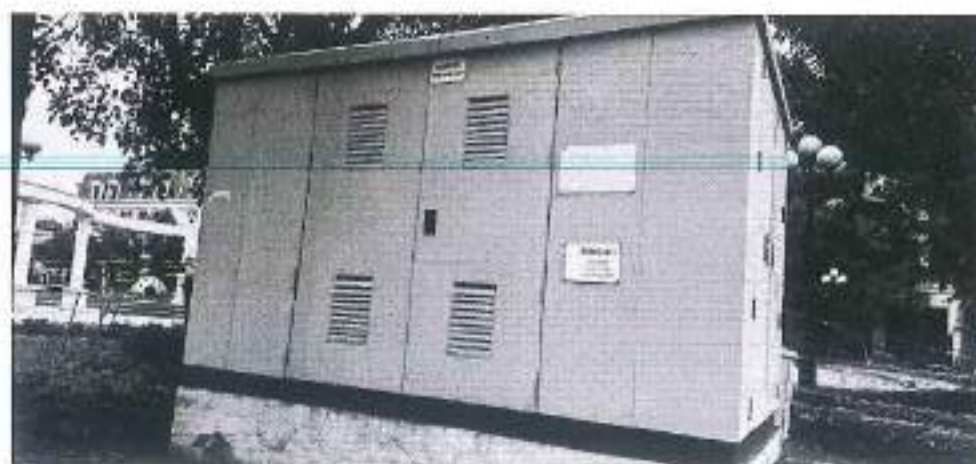
Hình 6. Trạm biến áp của cơ sở
