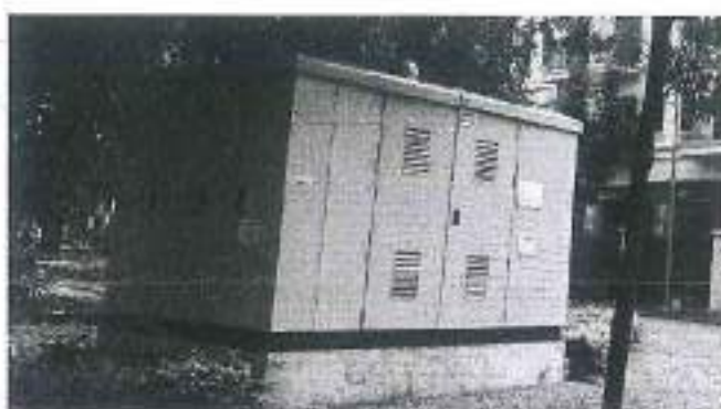
Hình 4. Hệ thống tủ điện của cơ sở
