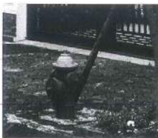
Hình 5. Hệ thống cứu hỏa của cơ sở
